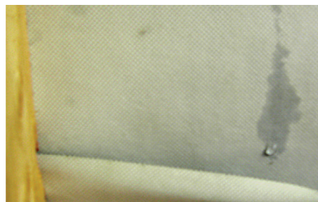
Poškození stěn v interiéru po vniknutí vody
