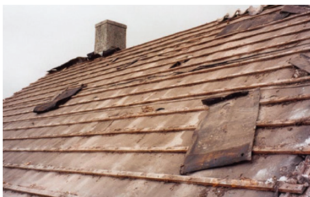
Zborcení konstrukce budovy působením hub a plísní
