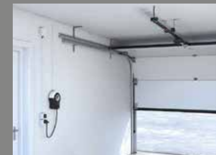
Řídicí jednotka v prostoru garáže
